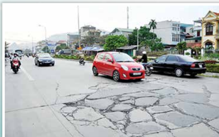
QL 18 đoạn qua TP Cẩm Phả trước đây xuống cấp, xuất hiện nhiều ổ gà do những tấm bê tông bị gãy, gây khó khăn cho các phương tiện qua lại, tiềm ẩn nguy cơ mất TT ATGT.
